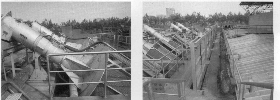
图 2 细格栅站设备管道腐蚀图
